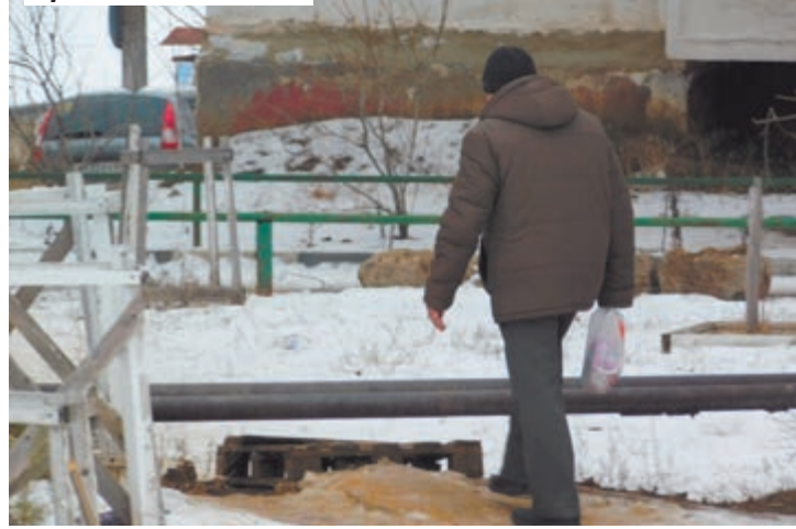
На теплотрассе не раз ломали ноги
