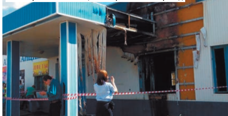
На аткарской автостанции выгорели касса и фасад
