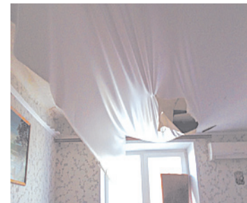
Тут косметическим ремонтом не отделаешься
